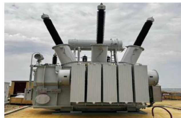
图：西班牙Sabinar II变电站项目
