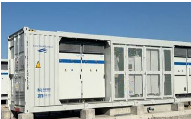
图：保加利亚202MW储能电站项目
