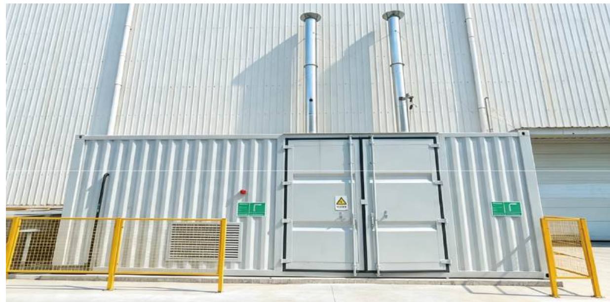
图:蒸汽发生器热水循环技改项目
