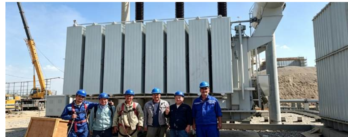
图：吉尔吉斯斯坦100MVA主变压器项目
