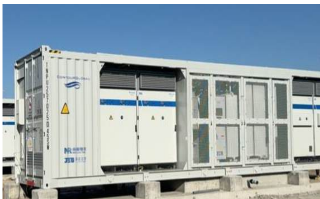
图：保加利亚202MW储能电站项目
