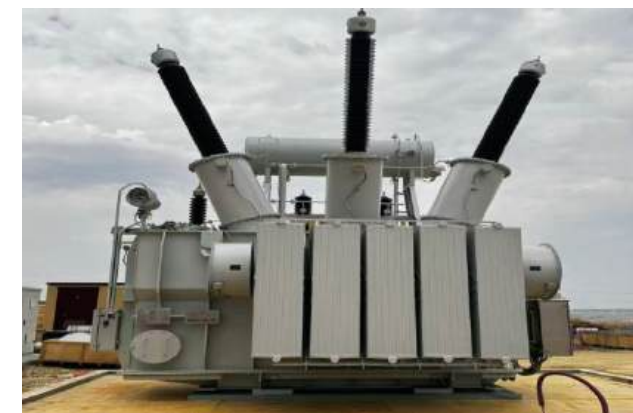
图：西班牙Sabinar II变电站项目
